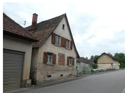
Abb. 73: Gebäude mit Sanierungsbedarf
