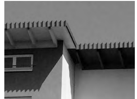
ABB. 056 ❌ NEGATIVBEISPIEL Unruhige Dachuntersicht
