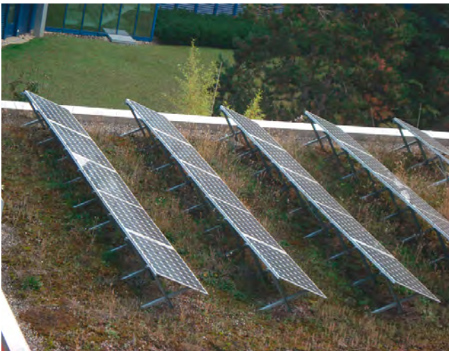
ABB. 059 Fotovoltaikanlage auf Gründach
