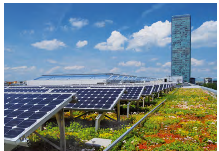
Abb. 55: Kombination aus Dachbegrünung und PV-Anlage, Nürtingen [DQ3]
